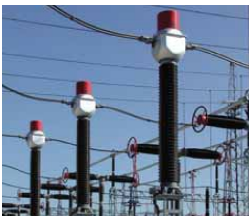
4. Transformadores de corrente de 420 kV. Rede Eléctrica Nacional (Portugal).
