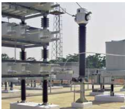
2. Transformador de corrente de 245 kV protegendo banco de capacitores (Índia).
