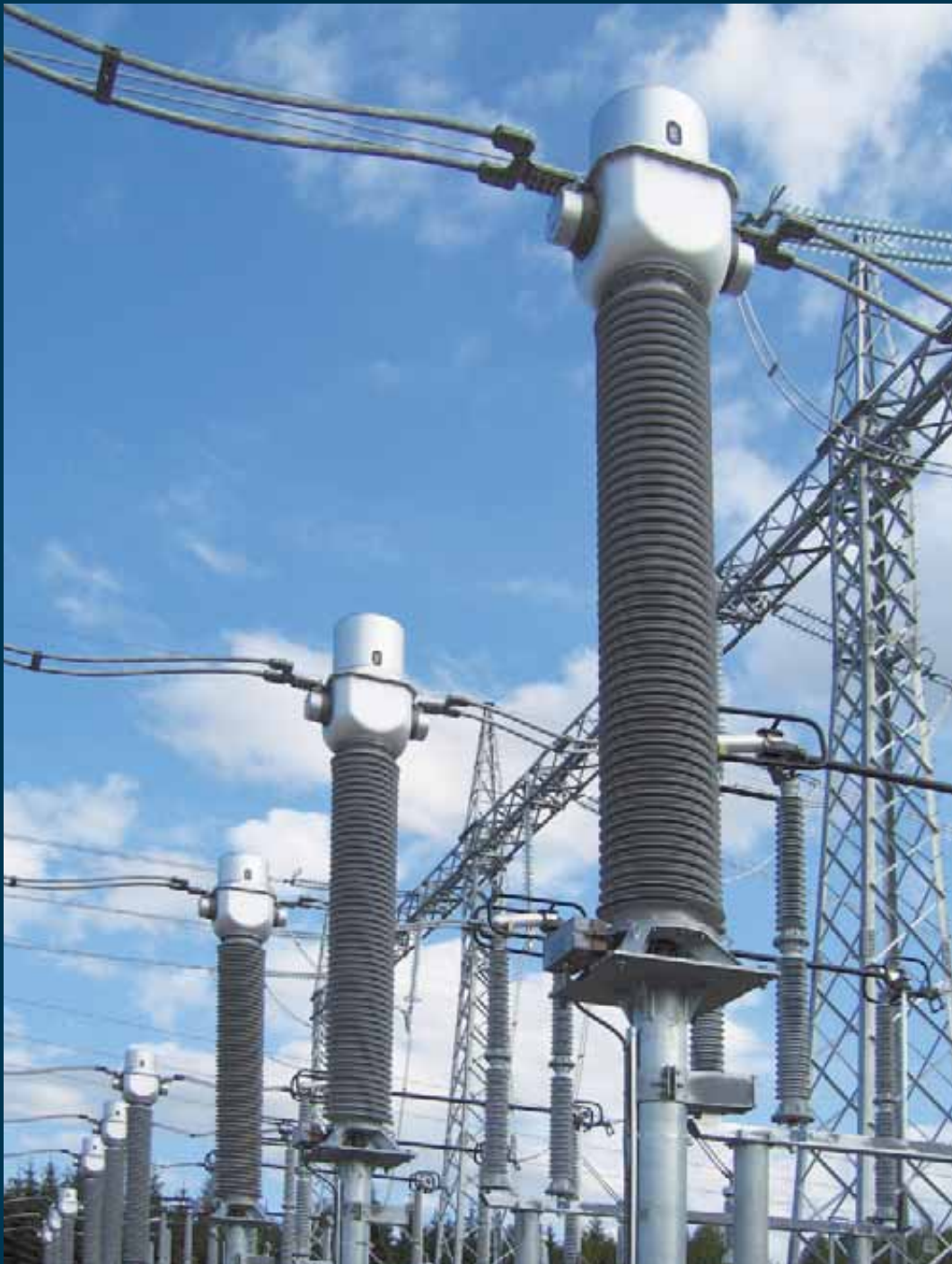
› Transformadores de corrente de 420 kV com isolamento de silicone cinza. Statnett (Noruega).
