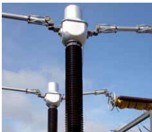
3. Transformadores de corrente de 420 kV. National Grid (Reino Unido).
