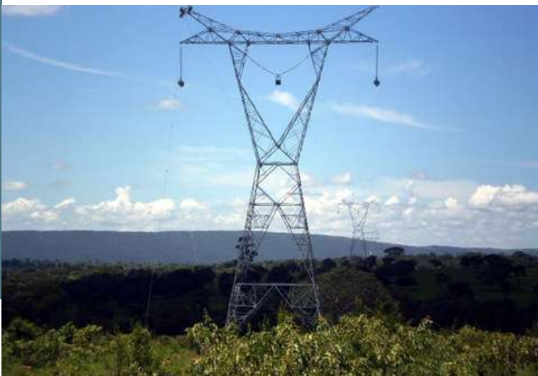
ESTRUTURA METÁLICA P/ LINHA DE TRANSMISSÃO
