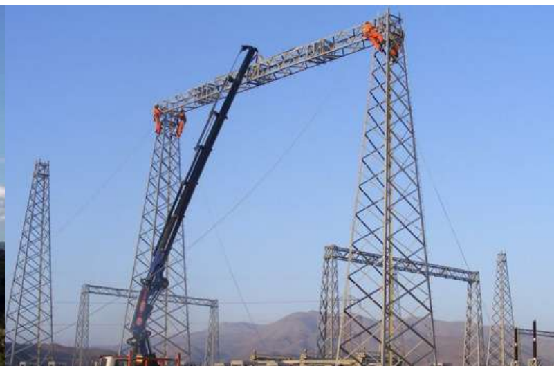
PÓRTICOS E ESTRUTURAS METÁLICAS PARA SUBESTAÇÕES
