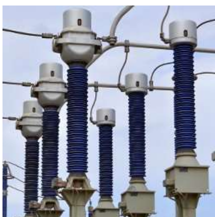
TRANSFORMADORES DE INSTRUMENTOS ALTA TENSÃO
